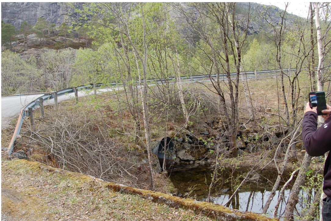
Trykkrøret må krysse kulvert ved P340
