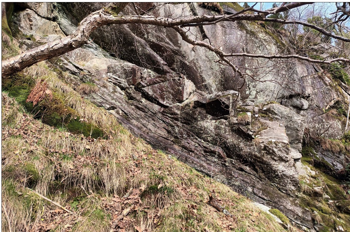
Figur 30: Bilete viser fjellpartiet nedanfor betongstrukturen (Figur 29) ved infopunkt 4. I søraust, nedst i påverknadsområdet, er fjellryggen hovudsakleg massiv i øvre del av partiet og at sprekkdanninga aukar i nedre del ved foten. Dette gjev låg fallhøgde for potensielle losneområde med høgst losnesannsyn.
