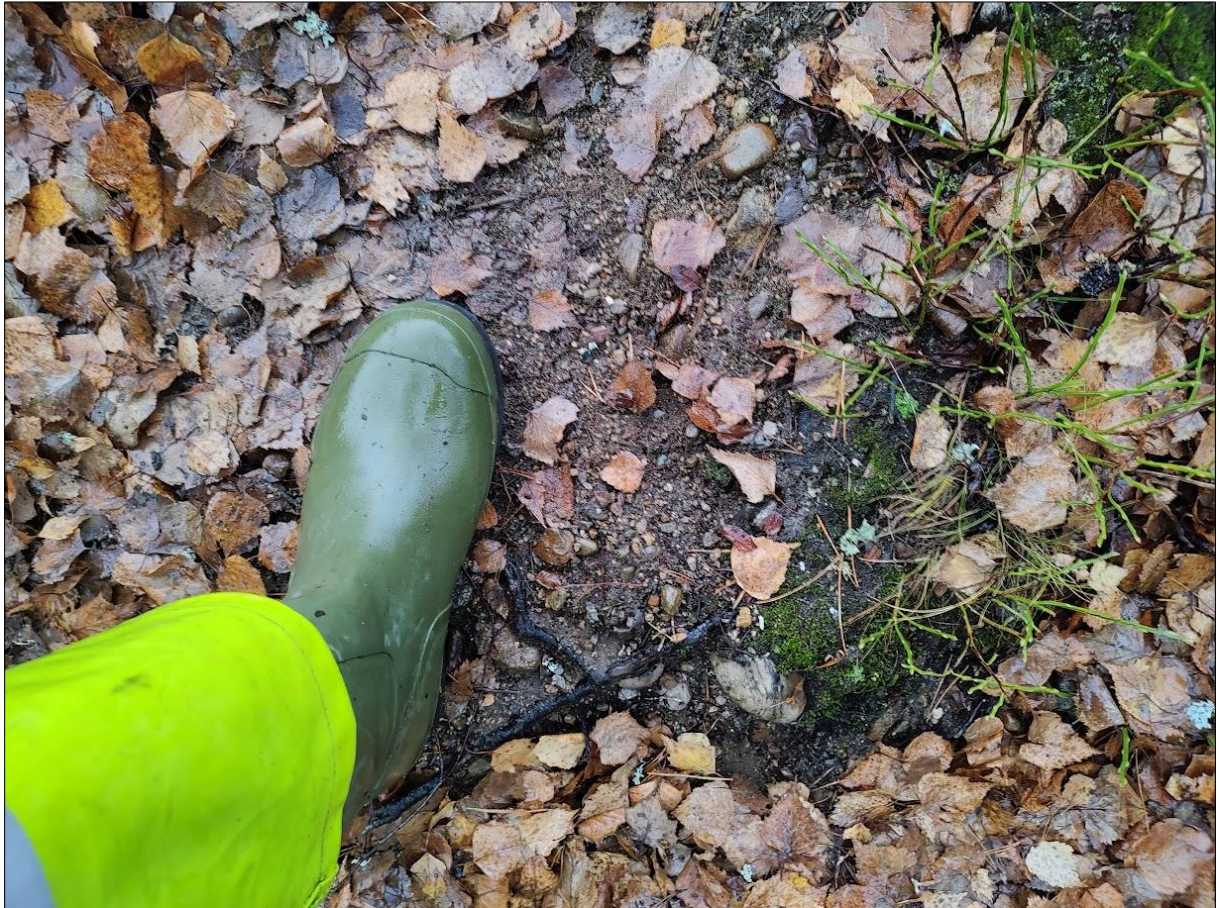
Figur 57. Sand og grus i skråning nedenfor mast 15 og 16.
