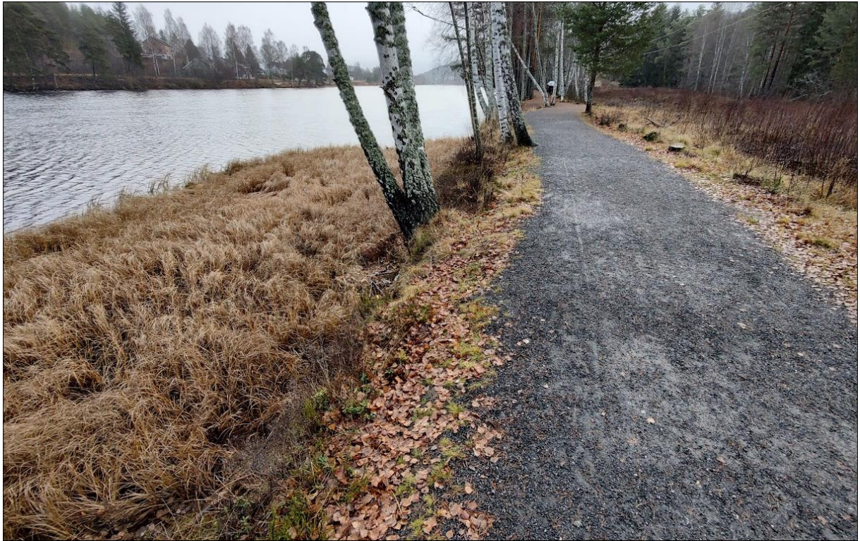
Figur 55. Bøyde trestammer indikerer sig i grunnen mot elva på nedsiden av gangsti langs elvebredden ved mast nr. 13 og 14.
