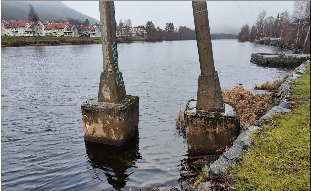
Figur 59. Mast nr. 19 med fundamenter som tyder på at det er fundamentert på fjell i Numedalslågen.
