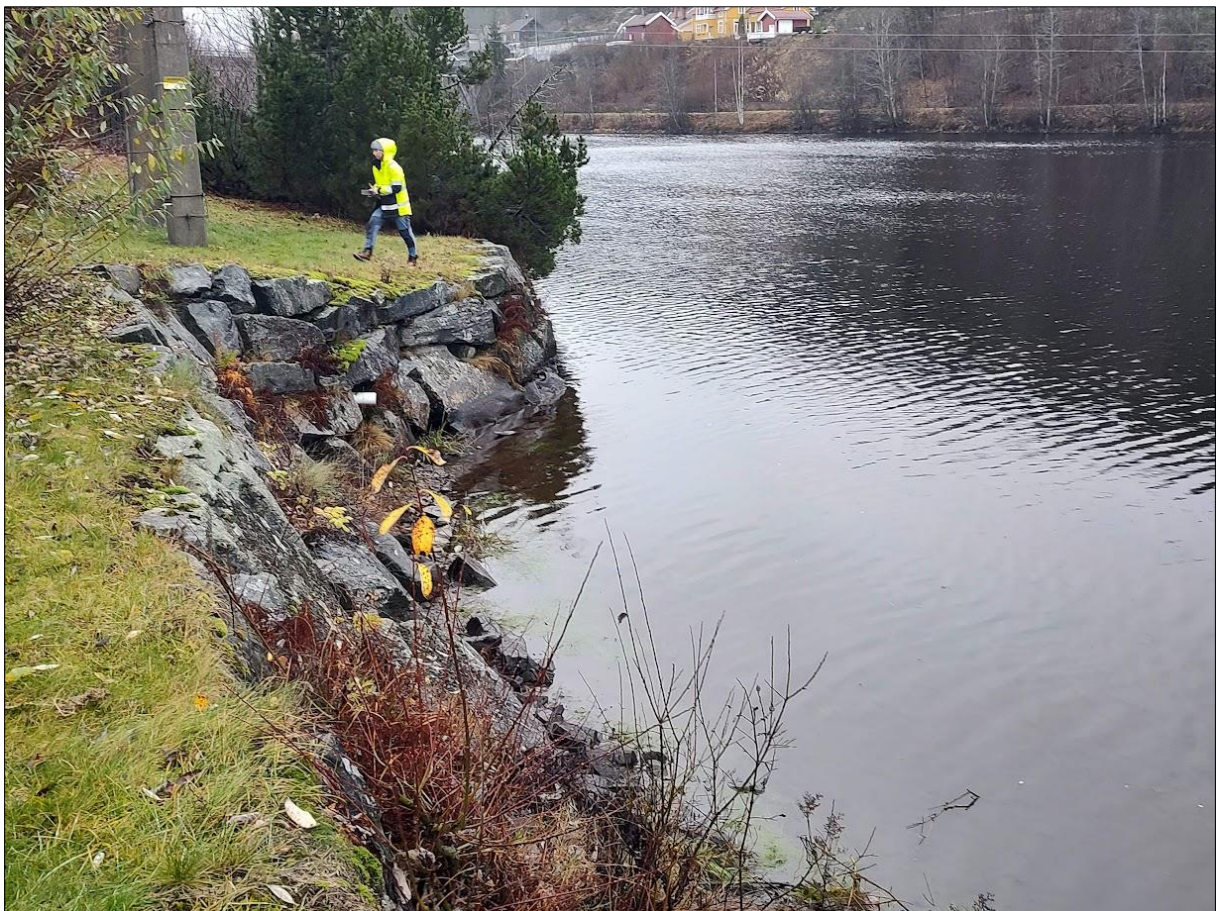
Figur 60. Bildet er tatt sørover mot mast nr. 20. Det er plastret mot elva nedenfor masten, og store blokker eller fjell nærmest i bildet.
