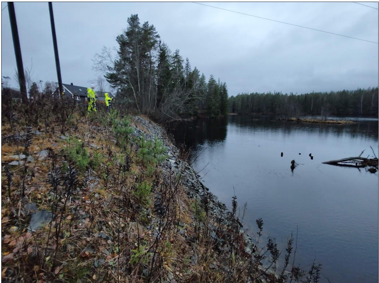
Figur 74. Plastring på nedsiden av mast 17, hvor det var en utglidning ved tidligere flom. Bildet tatt mot vest.
