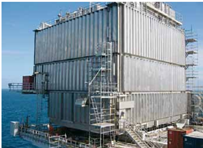
Fig 5. HVDC light® strømretteranlegg på gassplattformen Troll A. Kilde: ABB.
