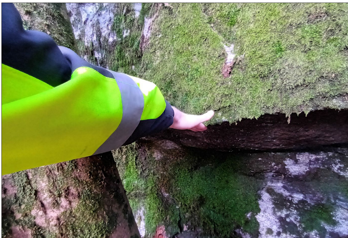
Figur 9: I nedre del av fjellskrånninga nord for kartlagt område er det observert nokre små overheng tett på bakken. Sprekkdanninga føl foliasjonsplana og hallar slakt mot nordaust, inn i fjellet. Infopunkt 4.
