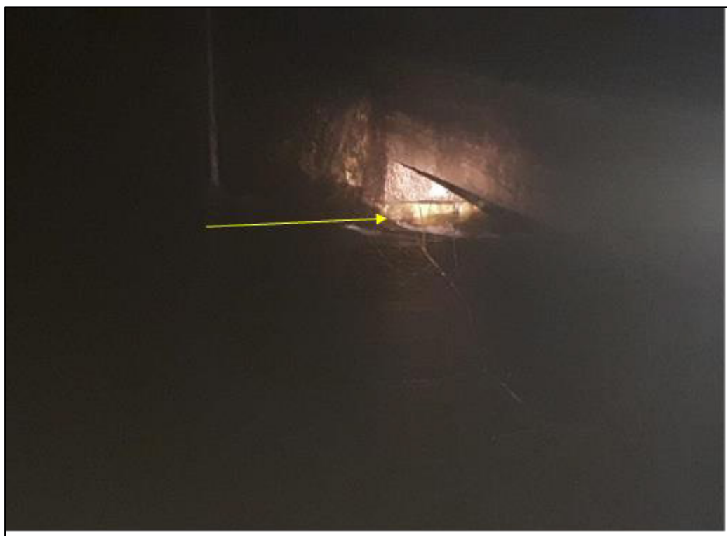
Bilde 37. Vasstand under bru-karet på Høydalsbrua (gul pil) etter kraftig nedbør og med vasstand i Ramsgrøvatnet på 145,44 moh., som er 44 cm over planlagt HRV. Målt høgde på underkant bru er 145,79 moh. (Billedato tatt 06.12.2017).
