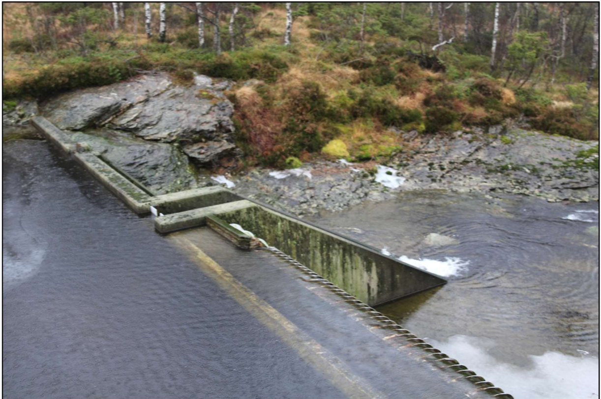
Figur 5: Eksisterande inntaksdam i Vakaelva, kote 263, med Coanda-inntak og fisketrapp. Foto 27. november 2022.
