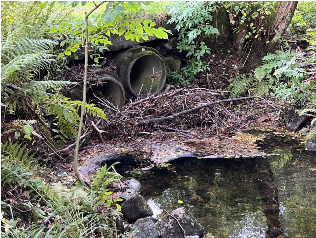
Figur 40. Den nederste kulverten i Øyabekken. Her går bekken gjennom flere rør under veien, og rørene er delvis tilstoppet.
