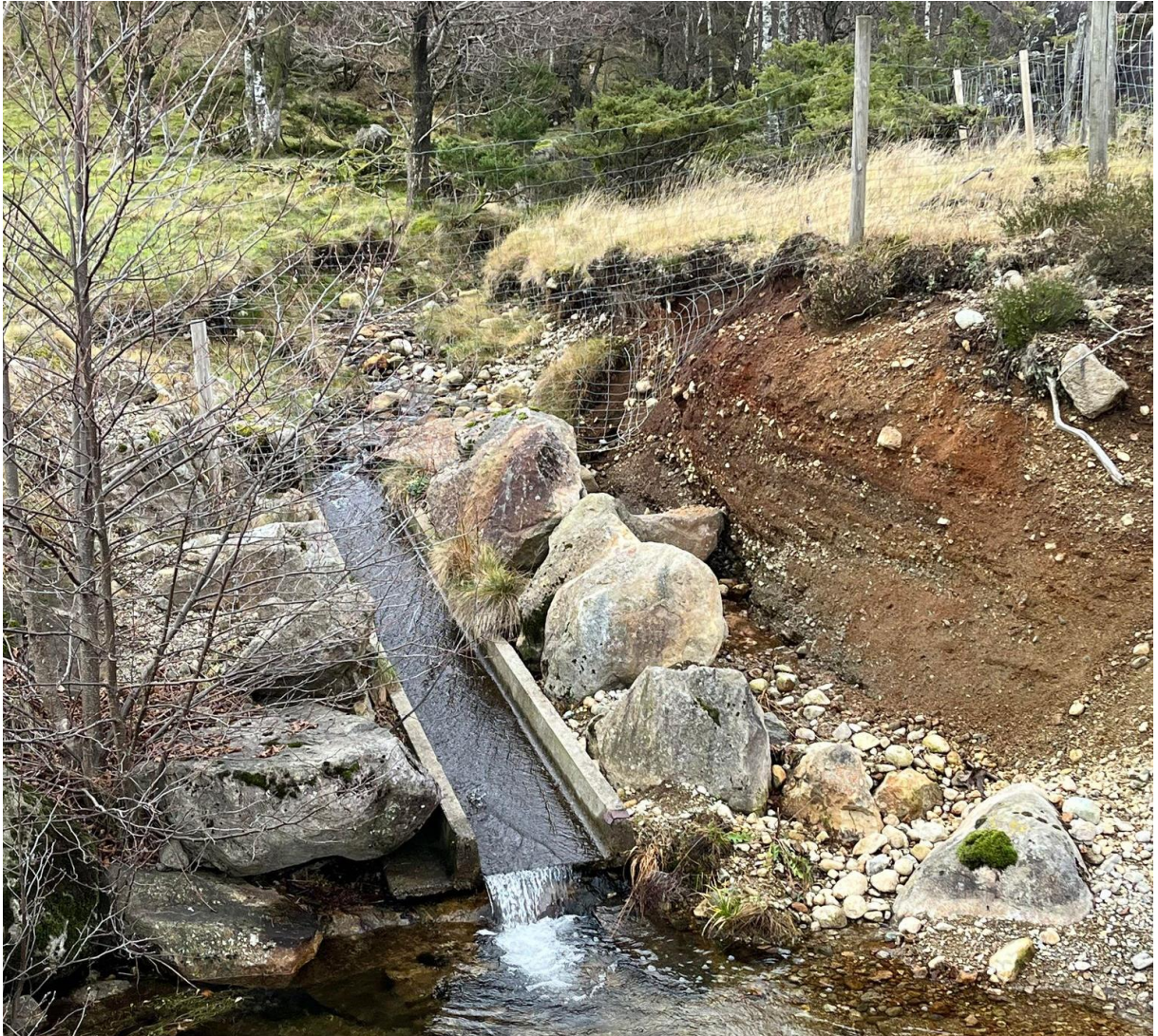
Figur 50. Utløpsområdet av sideløpet hvor det er laget en betongrampe og hvor landområdet er erodert langs ene bredden.
