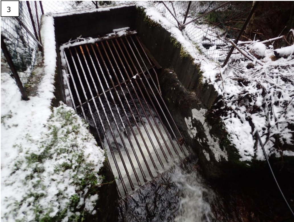
Figur 15. Rist sør i Bergsmodalen som leder vannet fra bekkene i kulvert/rør forbi barnehagen, under Rv. 9 og ut i elva.
