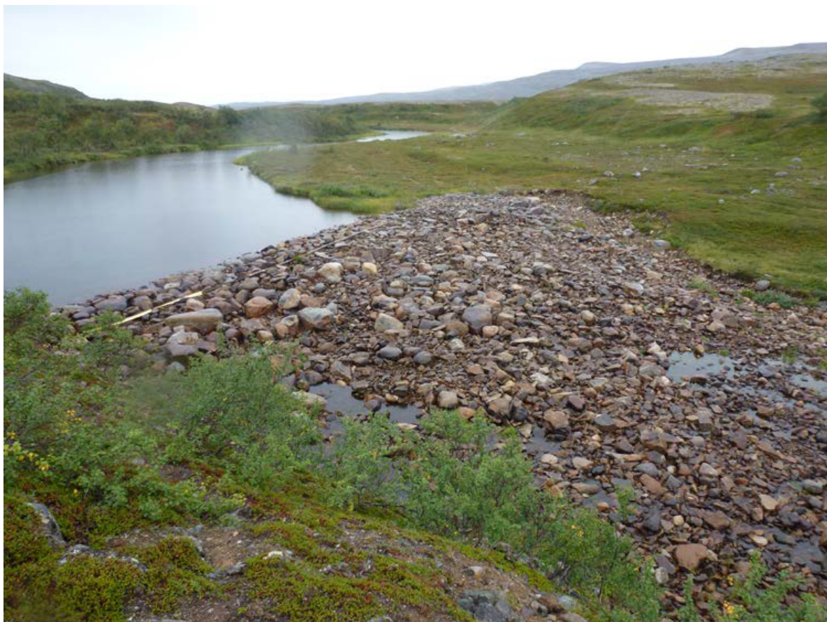
Figur 3. Lavt vannspeil i terskelbassenget forårsaket av lekkasjene på eksisterende terskel.
