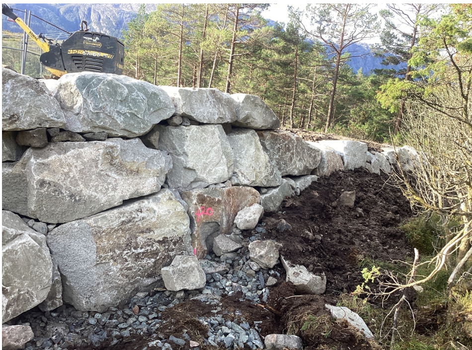
Bilde 9: Her vises flom- og skredvollen fra vestsiden der Lnett har påbegynt istandsettingsarbeidet. Foto: NVE
