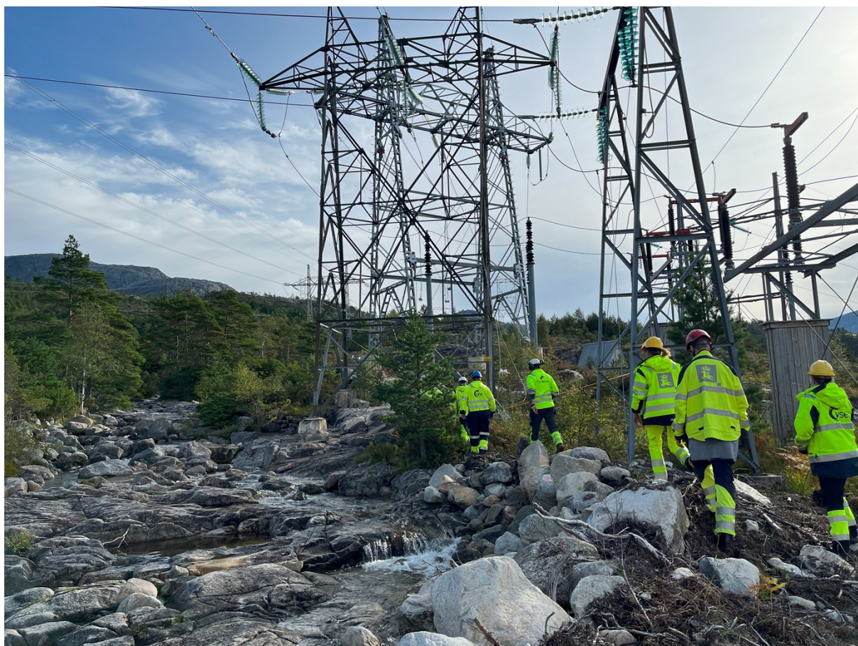
Bilde 10: Flom- og skredvoll er ikke er ferdig her, men skal følge vassdraget forbi masten midt i bildet. Bilde tatt i østlig retning. Foto: NVE
