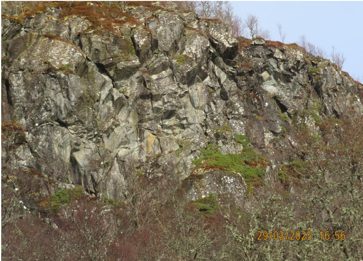
Figur 6 Den 50 meter høye fjellveggen øst for hytten – som utgjør løsnearealet for steinsprang
