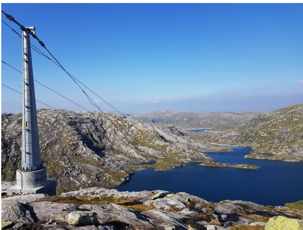
Figur 3-3: Tilsvarende løsning for monomaster parallelt med kraftledning (bilde er fra 300 kV Steinsland–Haugsvær). Foto: Statnett
