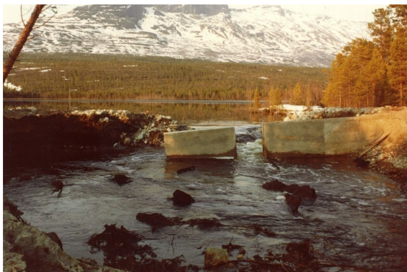
Bilde 5-3: Demningen ved utløpet av smoltbassenget i Nedrevatn etter dambrudd
