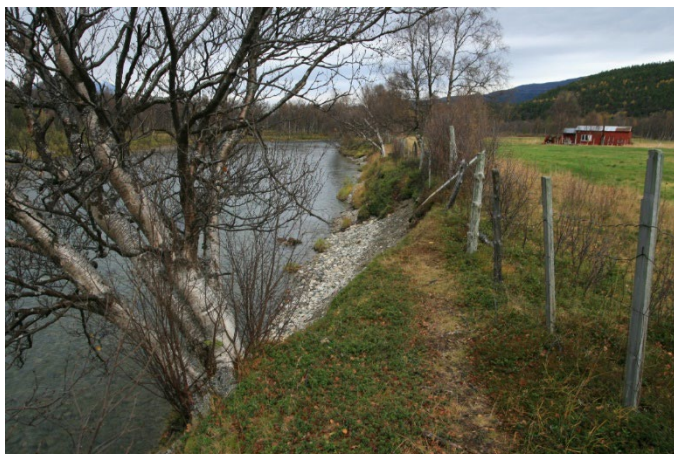
Bilde 7-3: Erosjon ved Kiholmen, tilsyn 2014
