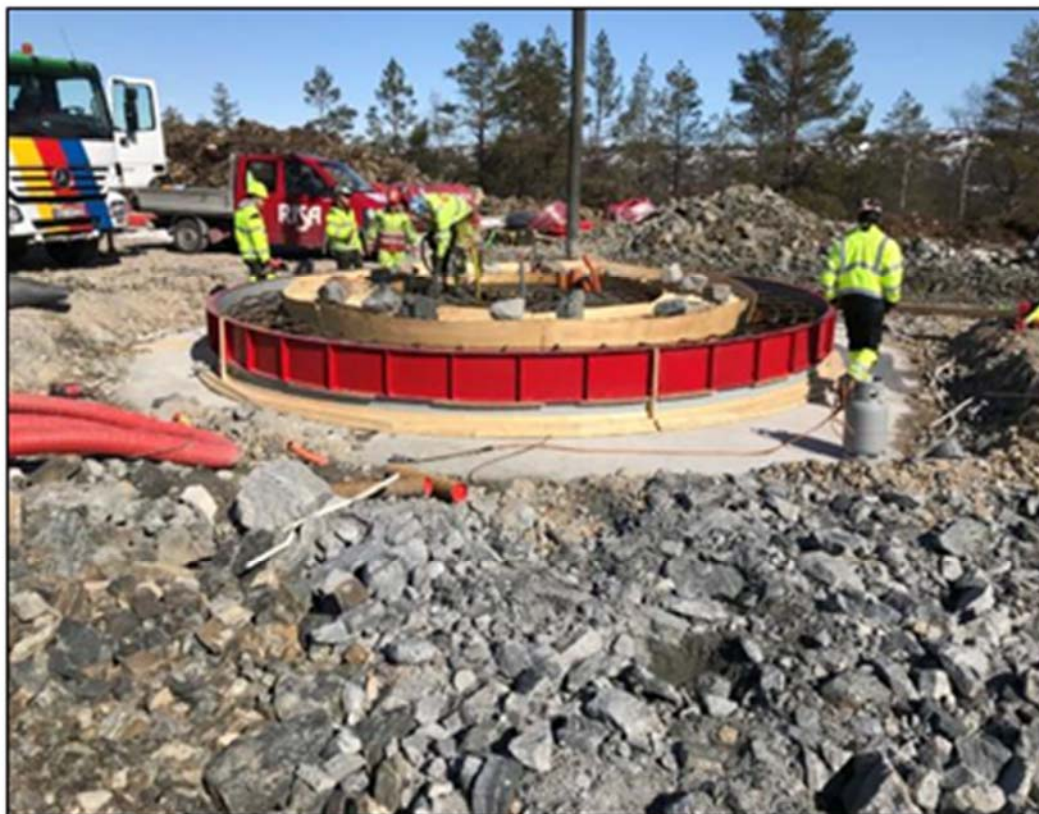
Figur 2-2. Støping av turbinfundament i Tonstad vindkraftverk. Mest sannsynlig vil det bli valgt samme type fundamentering på Skallhalsen. Foto: Tonstad Vindpark AS.
