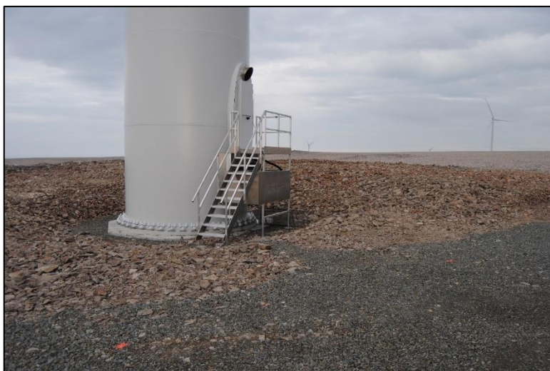
Figur 2-3. Turbinfundament og tårn i Raggovidda vindkraftverk etter tilbakefylling av masse. Foto: Multiconsult Norge AS.
