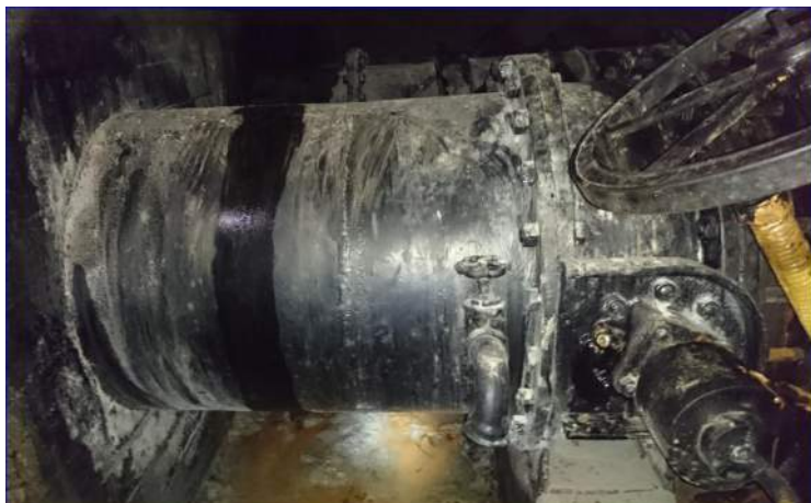
Figur. 3.5.3. Ein av tre parallelle tappeventilar i ventilkammeret.
