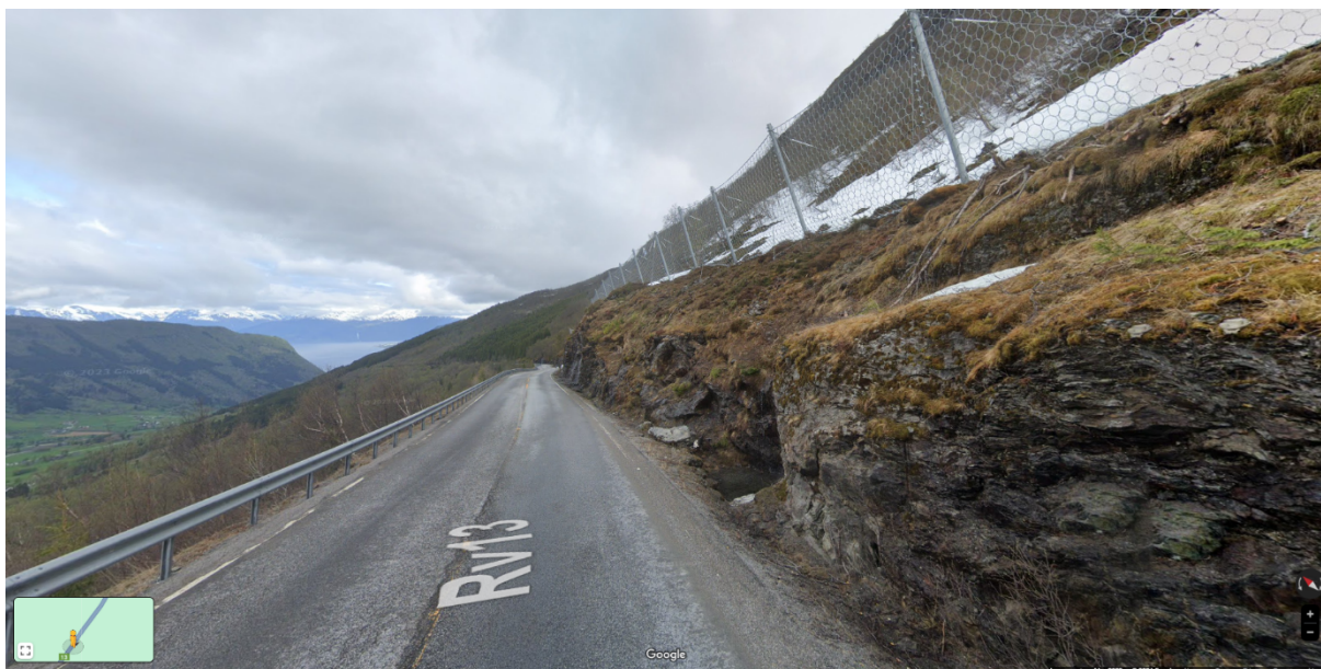
Figur 3-16: Strekning langs rv. 13. Foto frå strekningen viser at det er etablert fangnett på delar av strekningen [19] der det er registrert tidlegare hendingar. Dokumentasjon i SVV sitt vegkart [4] viser at fangggjerdet er 6 meter høgt, 274 meter langt og vart etablert i 2022.
