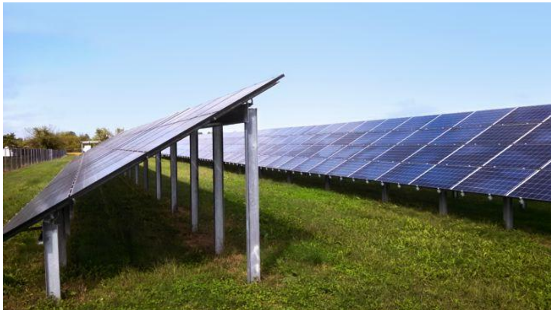
Figur 3-3: Eksempel på fast-vinkel installasjonsløsning (foto: Willowbrook Solar)
