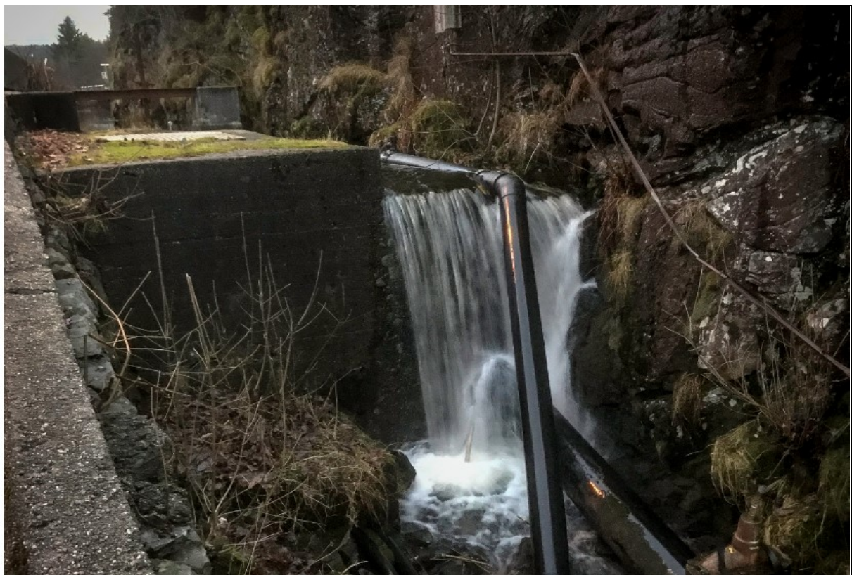
Figur 4. Dammen i utløpet av Storavatnet er vel 2m høy. De to inntaksledningene til anlegget i Tveitevågen er på 400 mm gjennom dammen og 250 mm over dammen. Det lekker 1-2 l/s gjennom.
