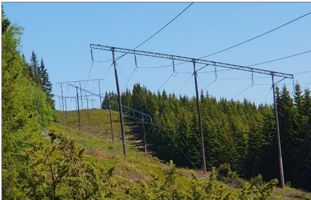
Figur 7-33: Eksisterende 132 kV ledning like sør for Venholshøgda. Ny ledning vil gå like i nedkant av disse.
