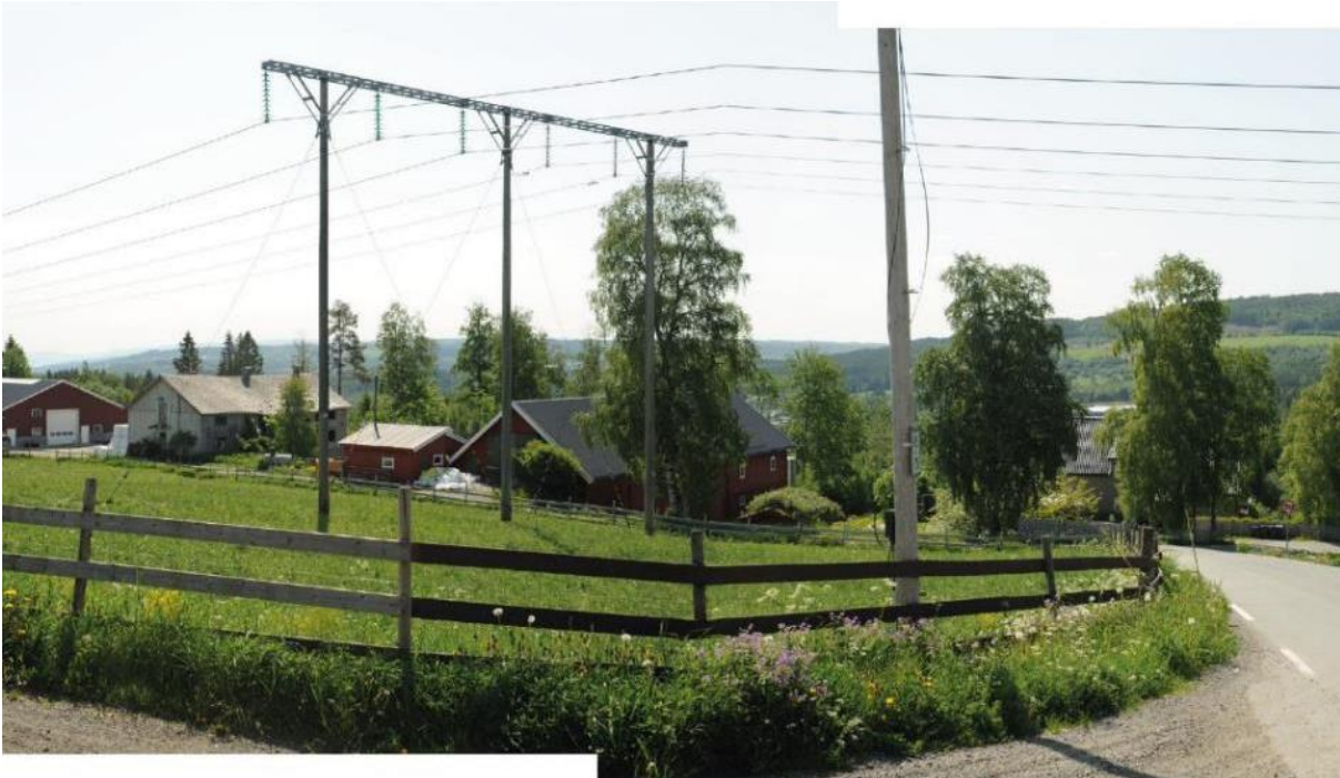
Figur 7-26 Dagens ledning ved Nedre Skjervum
