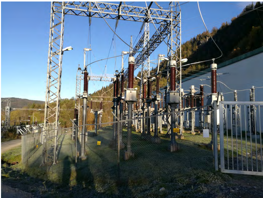
Figur 19: Eksisterende utendørs bryteranlegg ved Langvatn kraftstasjon
