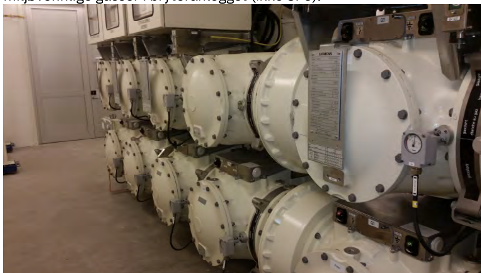
Figur 22: Eksempel på innendørs bryteranlegg
