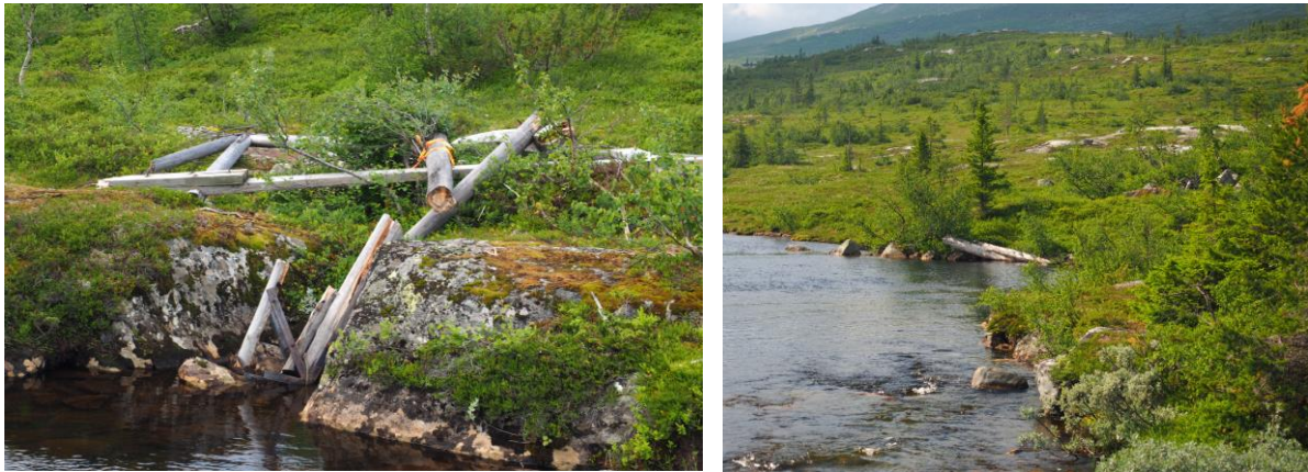
Figur 7: Rester av sammenrast gangbru (V) og rester av bunnstokk (H) som kollapset i 2020.
