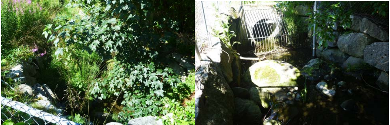
Utløp av rørledningen under gravlunden og inntak ovenfor gravlunden (bilder fra juli 2021)
