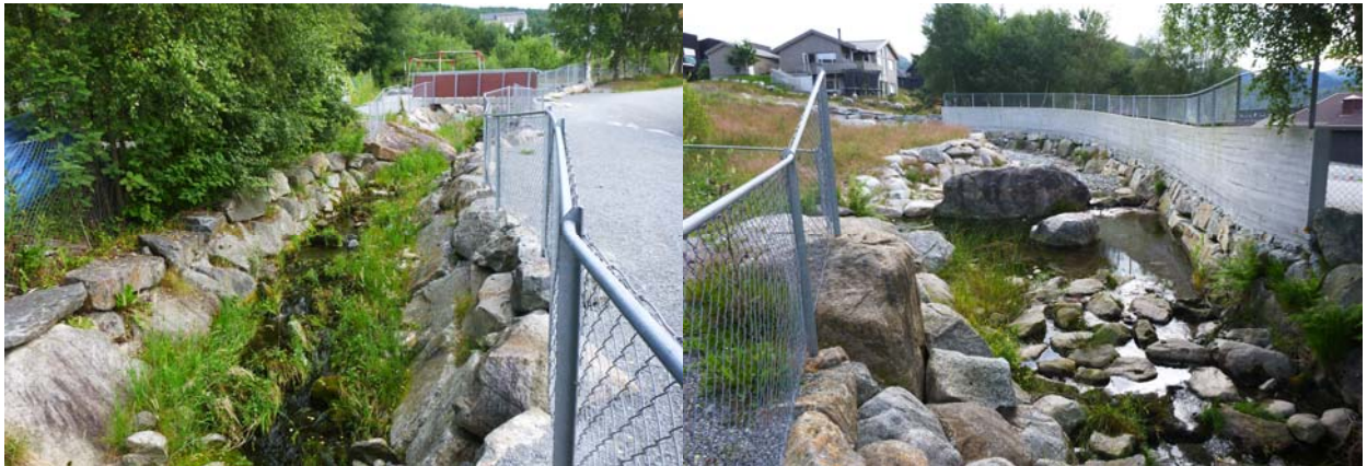
Nedstrøms byggverk nr. 210 og yttersving sikret med flommur ovenfor ungdomsskolen (bilder fra juli 2021)
