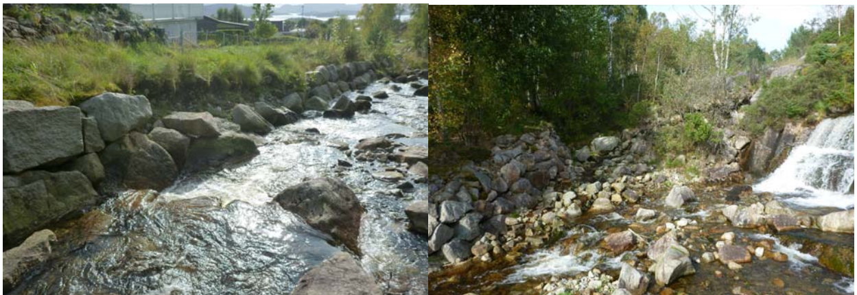
Erodert sidesikring ved utløpet av avskjæringsgrøft i Skardbekken
