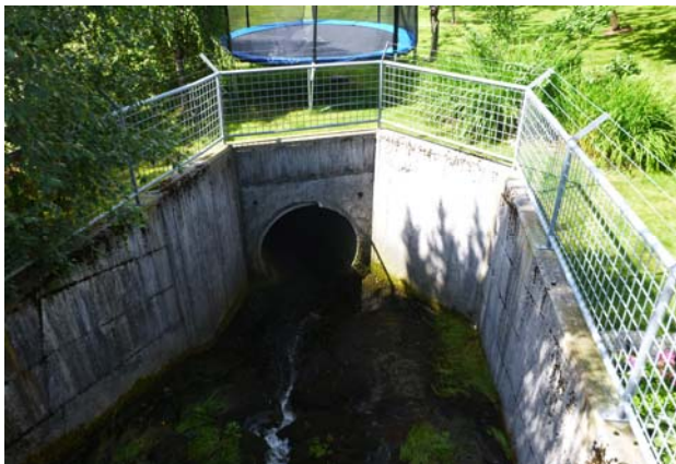
Inntak på Fjeldebakken (bilder fra juli 2021)
