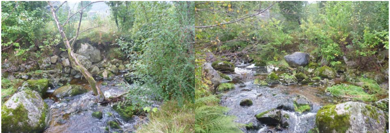
Tegn på erosjon og stein som har rast ut av østlig bredd oppstrøms Marmorvegen.
