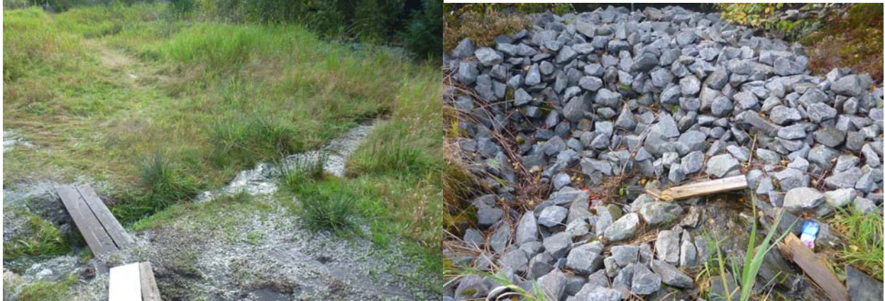
Inntak til Sørskårbekken i steinfyllingen nord for barnehagebygget
