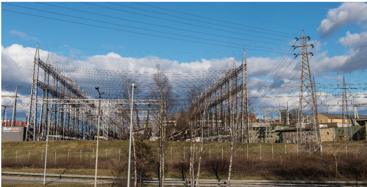
Figur 2. Luftisolert koblingsanlegg som skal rives, i dagens Ulven transformatorstasjon. Foto: Stig Storheil/NVE
