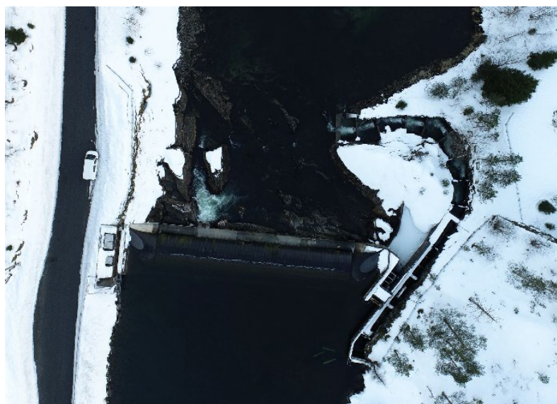
Gummidammen og fisketrappen ved Almelid. Vannføringen i restfeltet styres via et inntak i gummidammen.
