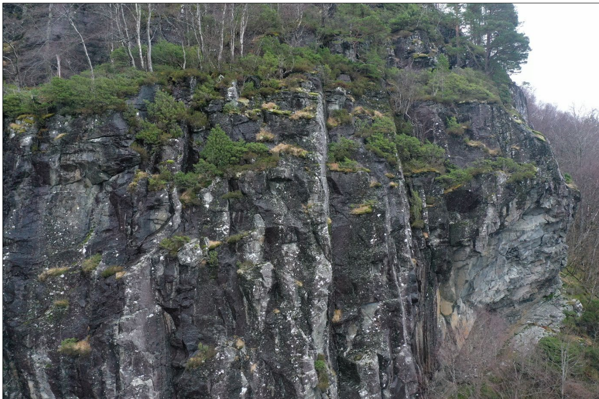
Figur 76: Fjellpartiet ved infopunkt 11 er oppknust i nedre del av overhenget som stikk ut frå fjellet, i tillegg til at det går større vertikale sprekkesett inn i fjellsida, normalt på foliasjonplana.
