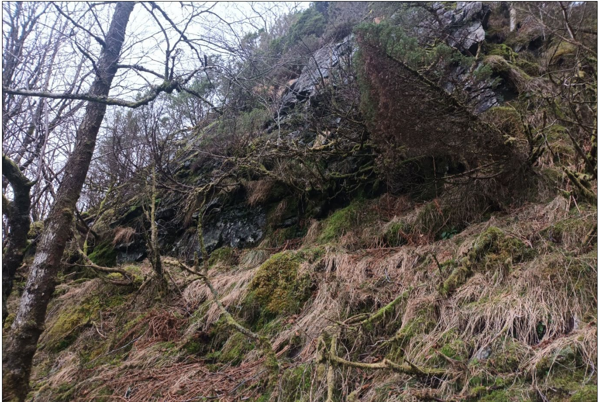
Figur 120: Fjellskråning ved infopunkt 8. Det er sprekkkeplan langs fjelloverflata og det ligg ei avgrensa ur direkte nedanfor. Terrenget 15 meter frå skråningsfoten har helling under 25^\circ .
