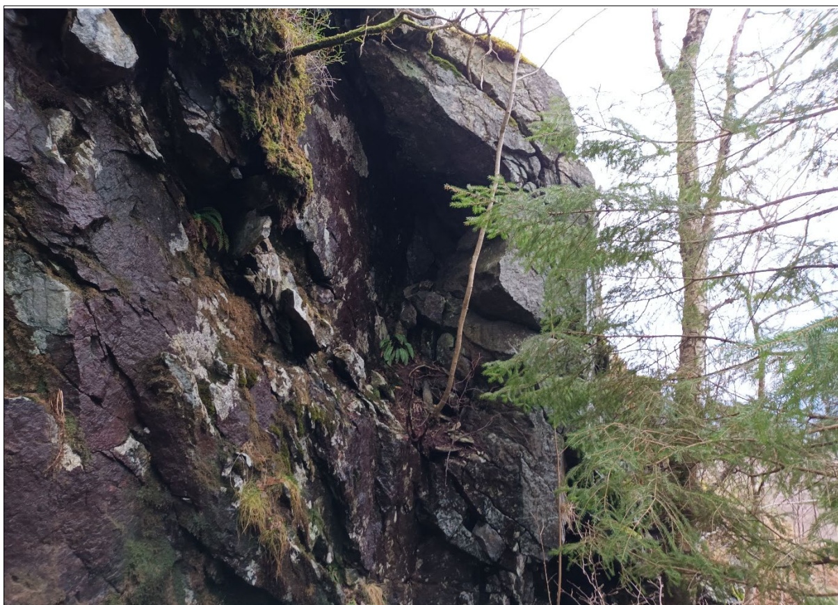
Figur 45: Hammaren i sørleg del av fjellpartiet rett aust for kartleggingsområdet. Sprekkeplan langs og normalt på foliasjonsplana har ført til overheng i hammaren. Infopunkt 4 (kap. 16.4).
