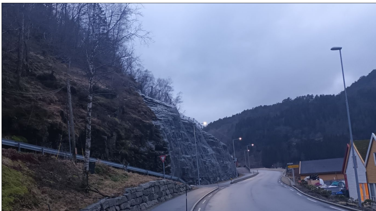
Figur 140: Skjeringa langs vegen vest i kartleggingsområdet er sikra med sikringsnett og vaiernett i sjølve skjeringa, og eit fanggjerdje ovanfor skjeringa.
