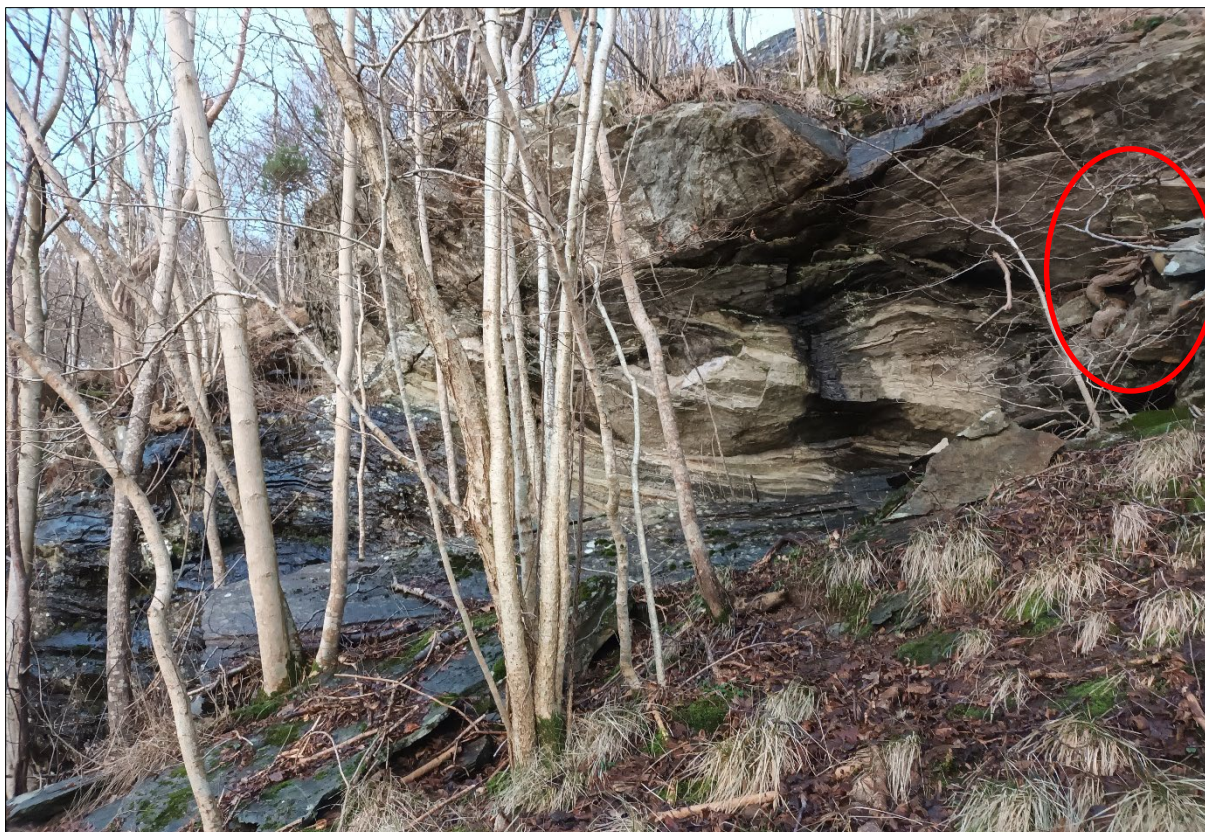
Figur 63: Overheng i fjellpartiet ved infopunkt 6. Steinsprangmateriale direkte nedanfor er vurdert å vere relativt ferskt (<100 år), og vegetasjon i fjellet vil føre til rotsprenging (markert med raudt omriss).
