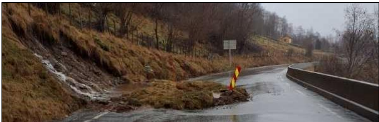
Figur 12: Utglidning på veg 5. mars 2025 sørøst for tomt på 53/2. Kilde: (Statens vegvesen, 2025).
