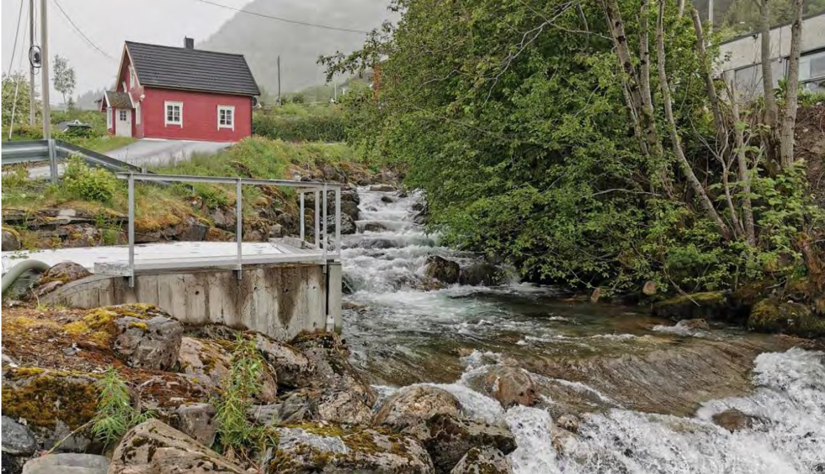
Bilde 3 – Inntaksrenne med bevegeleg front
