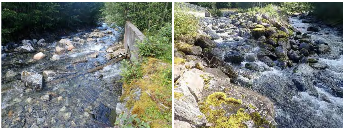
Figur 2. Inntak til vannverk til venstre, og tilbakeføring av overskytende vann til hovedløp til høyre.
