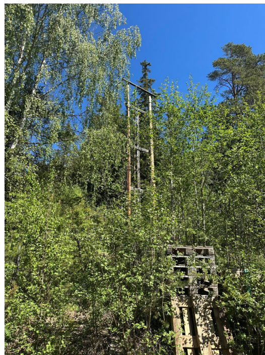
Påkopling til HS-mast for lokalt nettselskap
