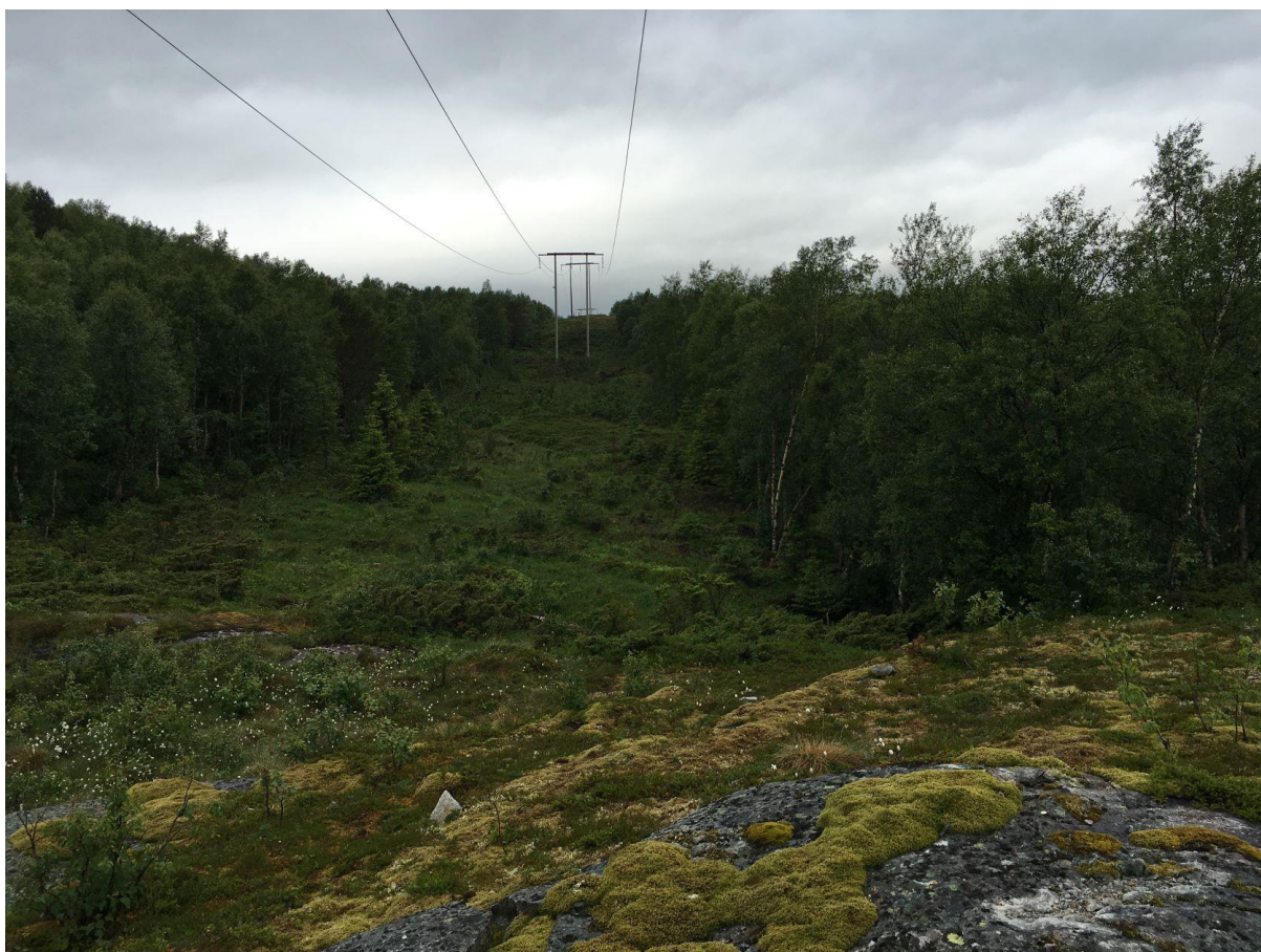
Figur 10 Eksisterende 132 kV nett i retning sør-nord. Adkomstvei vil krysse under nett-traseen.
