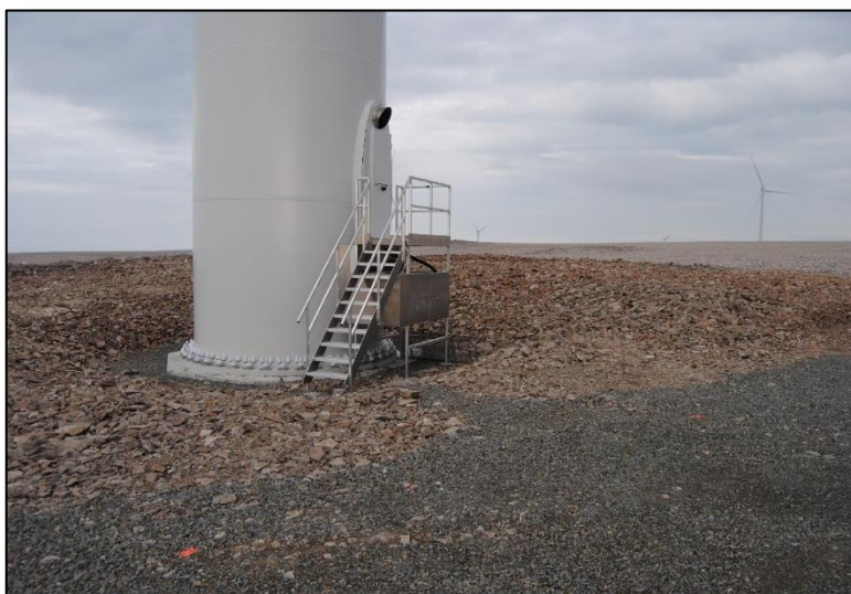
Figur 3-2. Turbinfundament og tårn i Raggovidda vindkraftverk etter tilbakefylling av masse. Foto: Multiconsult Norge AS.
