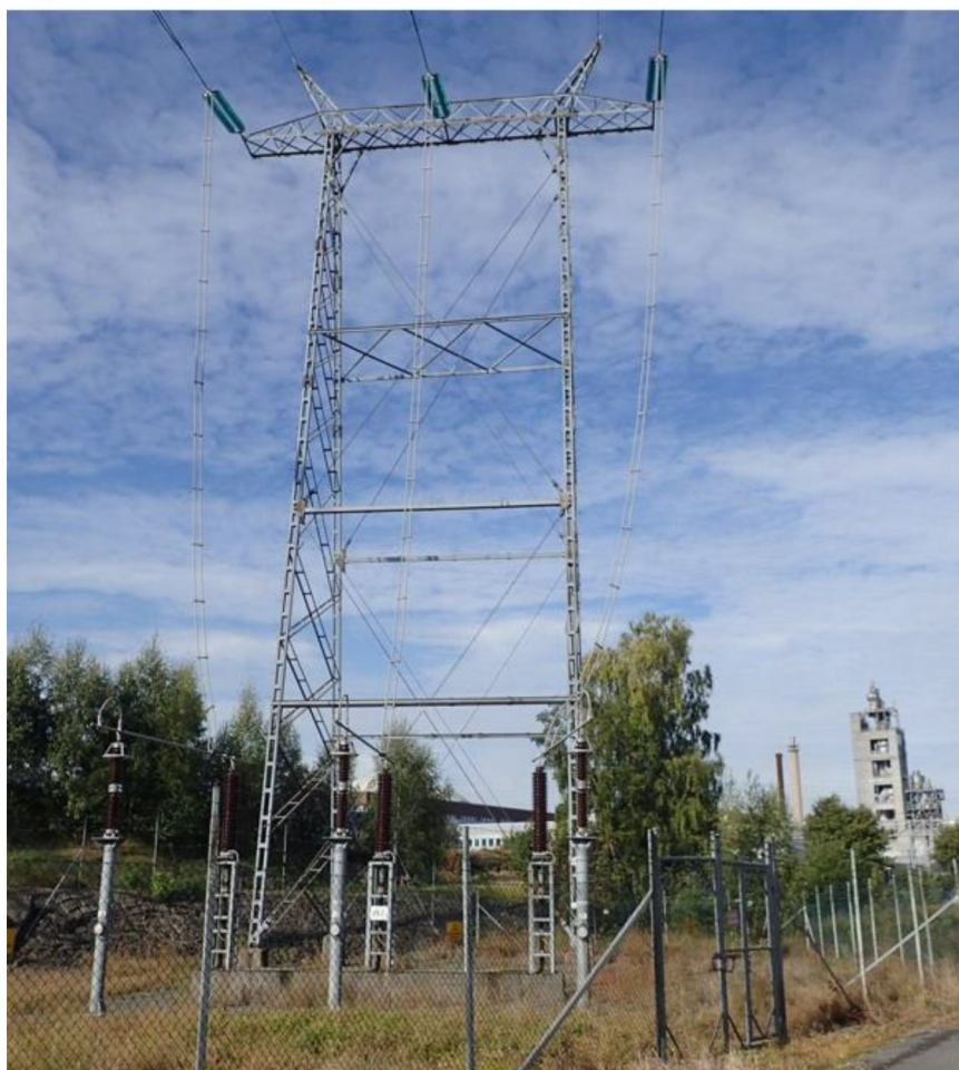
Figur 4-1. Eksempel på endemast og kabelsøyler. Bildet er fra ledningen Porsgrunn – Eidanger (Kilde: Lede).
