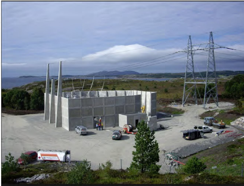
420 kV Fræna – Ormen Lange/Aukra. Bildet viser muffehus (overgang luftledning – sjøkabel) i Fræna.
