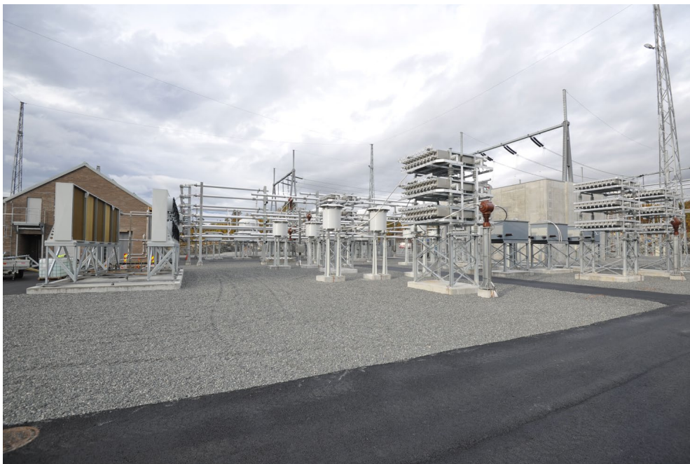
Figur 8: Det er avsatt areal på stasjonsområdet for etablering av SVS anlegg. Bildet viser tilsvarende SVS anlegg som er etablert i Sogndal. Kilde: Statnett 2023
