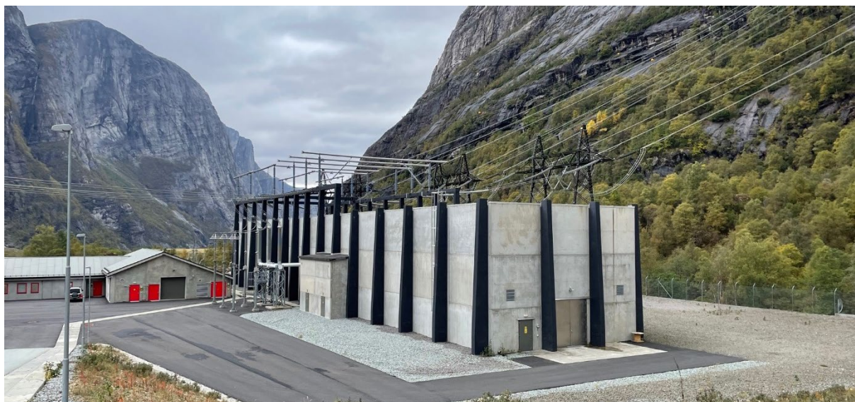
Figur 7: GIS-bygg fra Lysebotn. Omsøkt nytt GIS-bygg på Øygarden stasjon planlegges med samme materialbruk og farger. Statnett standard kontrollbygg ses til venstre i bildet.
