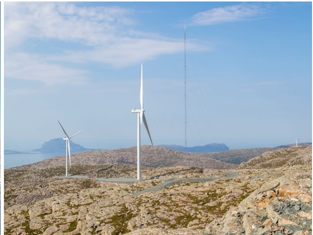
Figur 1-3 - Foto fra Guleslettene vindkraftverk. Foto: Eviny AS
