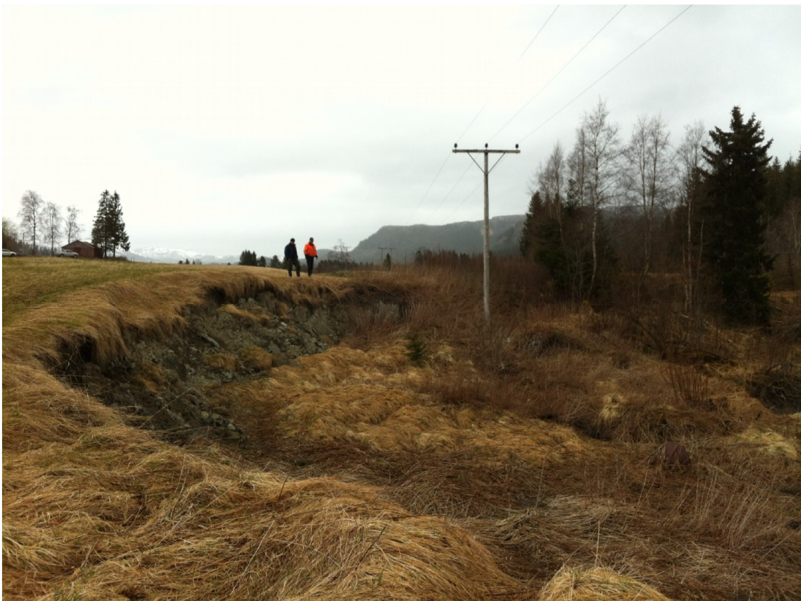
Bilde 2: Stor utglidning i venstre yttersving ca ved P550. Trolig skjedd vinter 2012.
