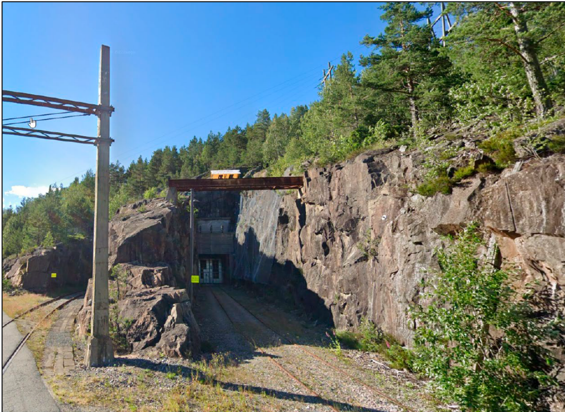
Figur 3: Bildet viser nåværende inngang til Nelaug omformerstasjon. Kilde: Bane NORs konsesjonssøknad av 2. februar 2026.
