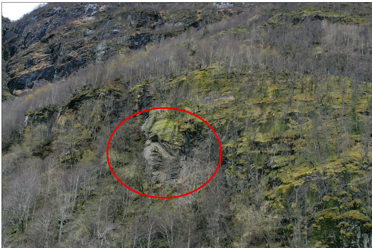
Figur 9: Sprekkeplan langs fjelloverflata ved infopunkt 4 (raudt omriss) dannar ein flakstruktur langs brotplanet/hammarpartiet.
