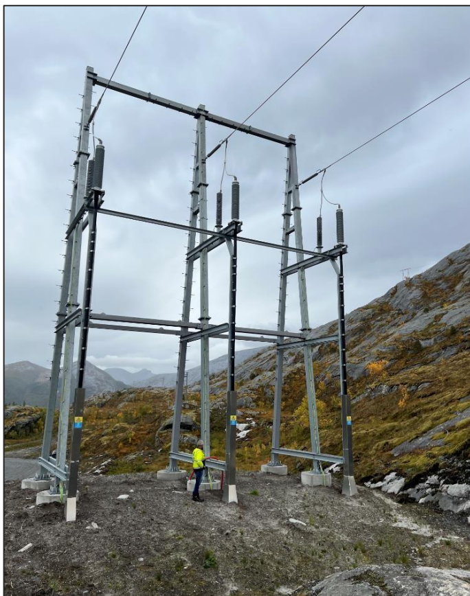
Figur 3-4: Kabelendemast (A3) i stål. Foto Norconsult.
