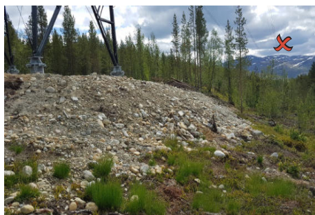
Figur 26: Vegetasjonsmasser er ikke lagt ut som topplag. Selv om det er et område med skrint jordsmonn, må det som er av vegetasjonsmasser tas vare på for istandsetting. Ut plassering av vegetasjonstuer ville ha brutt overflaten, og lagt grobunn for raskere naturlig revegetering.
