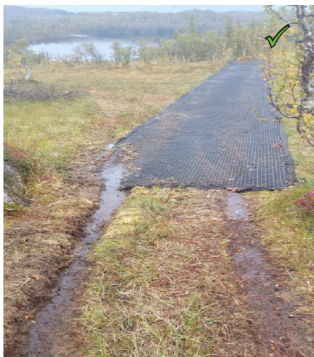
Figur 4: For å unngå kjøreskader over et bløt parti, er terrenget forsterket i forkant.
