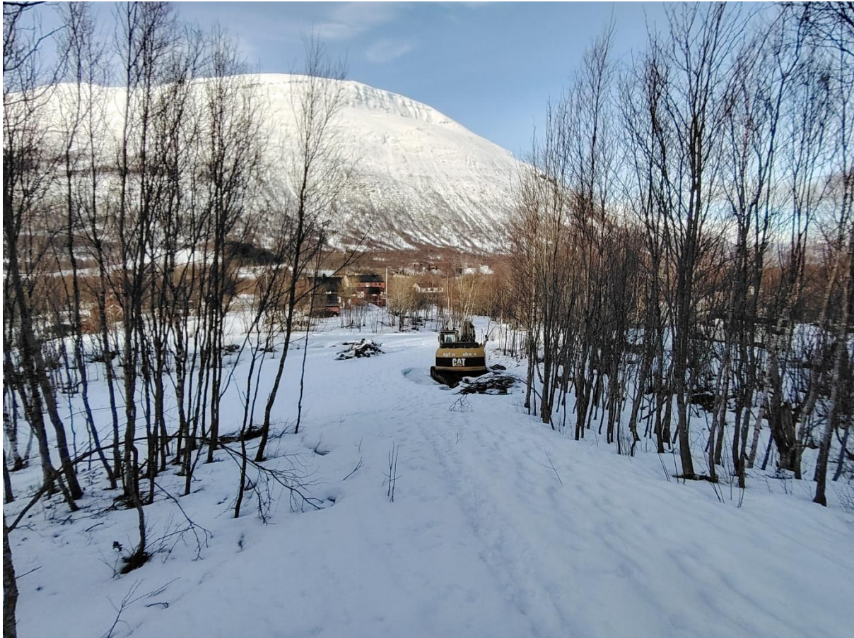
Figur 5-5 Adkomstvei inn til tiltaksnr. 12-21. Kraftledningen ligger ca. 100-200 m inn i terrenget, men i praksis er disse områdene svært nærme eksisterende bebyggelse. I tillegg kommer tiltakene helt i det nordvestre hjørnet av den store naturlige beitehagen som samebyen benytter før kalvemerking. Det begrenser de negative effektene i anleggsfasen.
