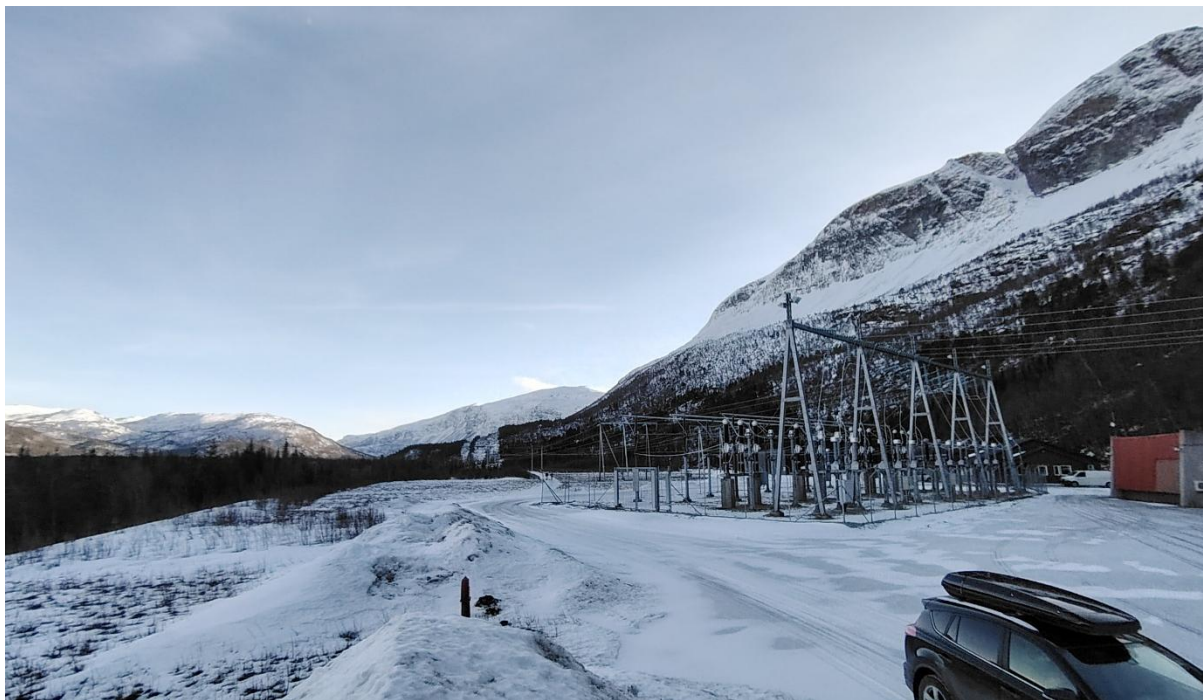
Figur 5-3 Skibotn transformatorstasjon. Her noen hundre meter inn langs traseen kommer totalt to nye mastepunkter (og to til på strekningen videre nordover, se Eftestøl og Rannestad 2025).
