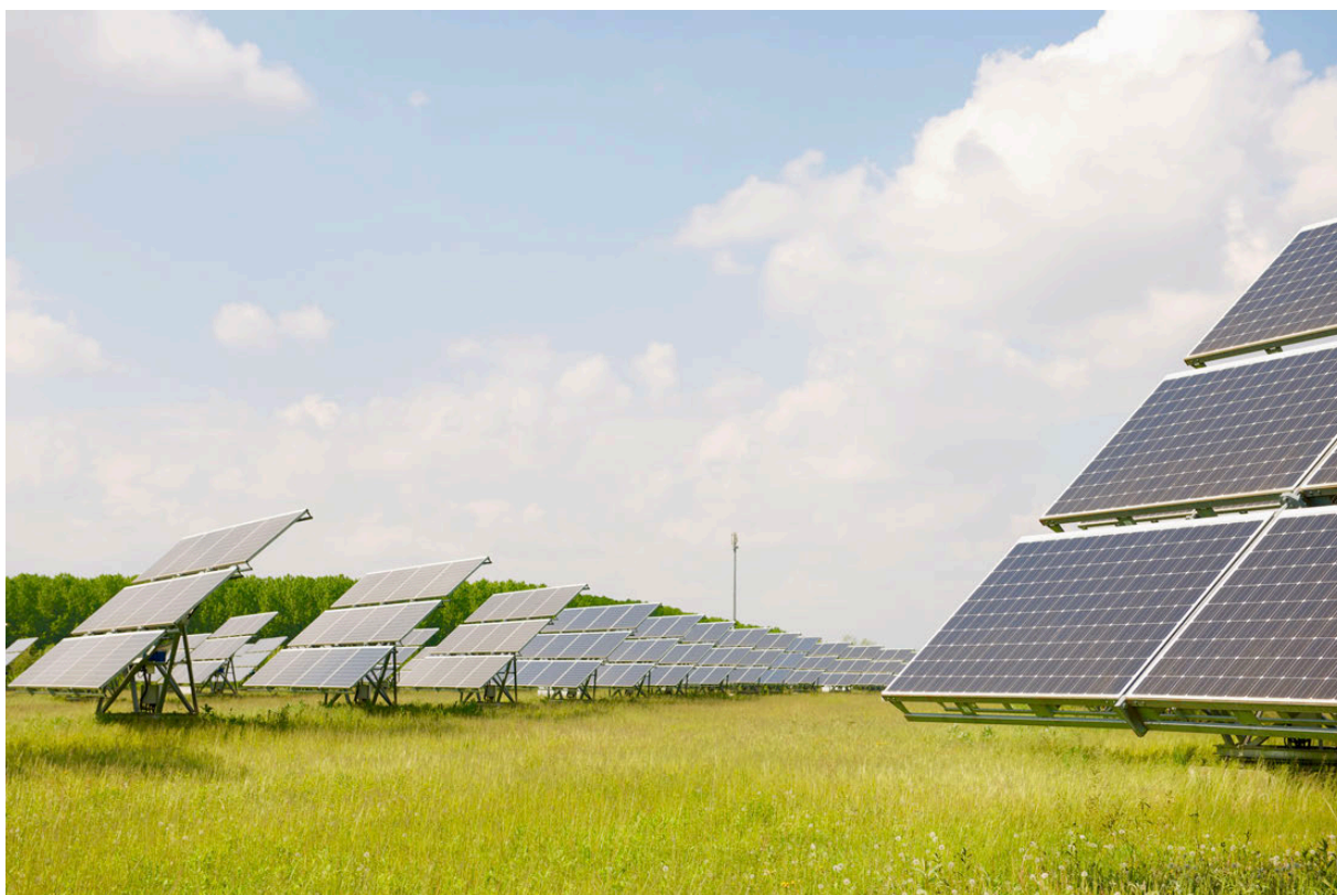
Figur 6 Bilde fra Energeia-gruppens solkraftverk i Friuli-Venezia Giulia, i Italia, med to-akse følgestructur.
