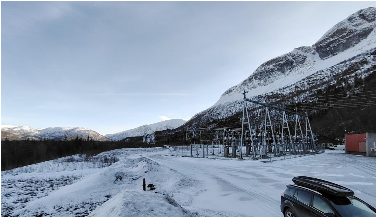
Figur 5-3 Skibotn transformatorstasjon. Her noen hundre meter inn langs traseen kommer totalt to nye mastepunkter (og to til på strekningen videre sørover, se Eftestøl og Rannestad 2025).
