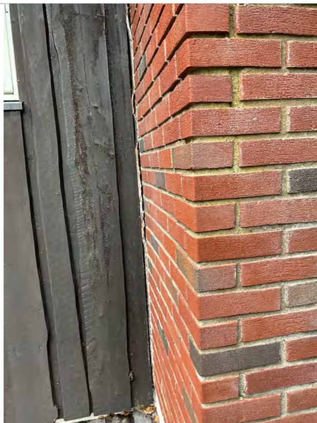
Bilde 17: Sprekk i konstruksjon mellom opprinnelig hus og tilbygg. 2023.
