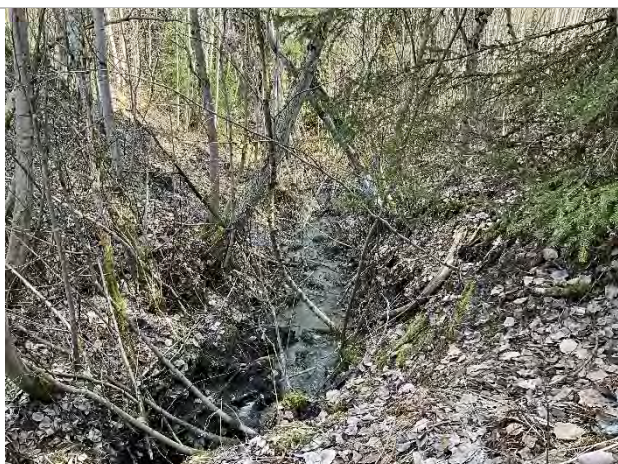
Bilde 36. Samme sideravine litt nedstrøms (ikke plastret). Sig i skråningen, litt erosjon.
