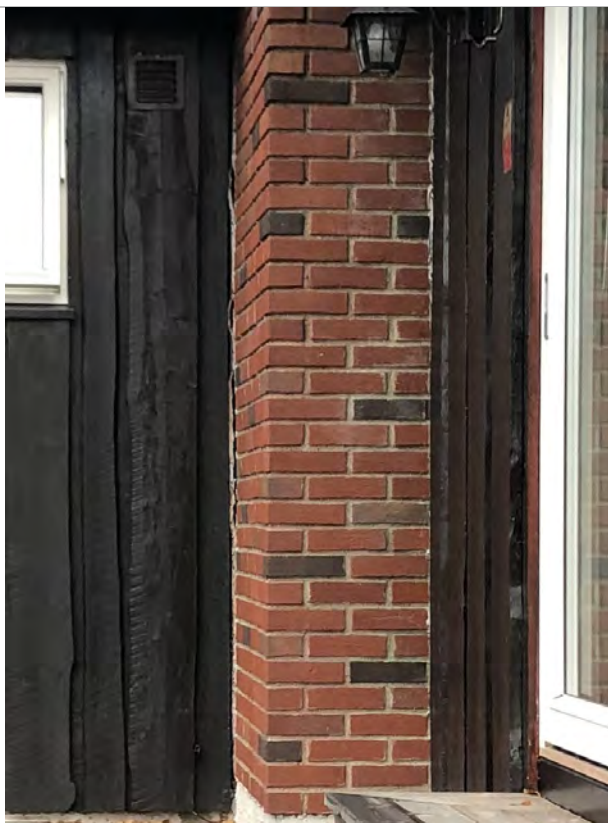
Bilde 16: Sprekk i konstruksjon mellom opprinnelig hus og tilbygg. 2018.
