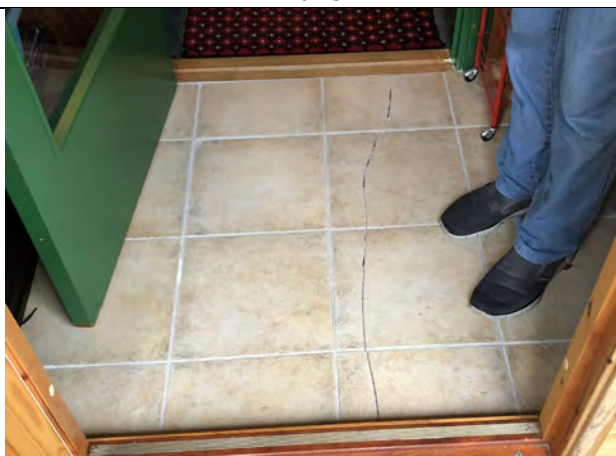
Bilde 8: sprekk i flis i gangen i underetasje. 2018.
