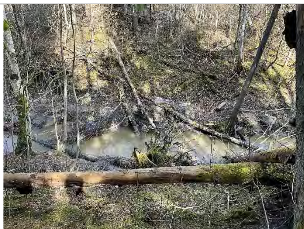
Bilde 37. Litt erosjon på vestkanten. Mange velte trær. Også bøyd trestammer nederst i skråningen (sig). Sett mot nordøst.
