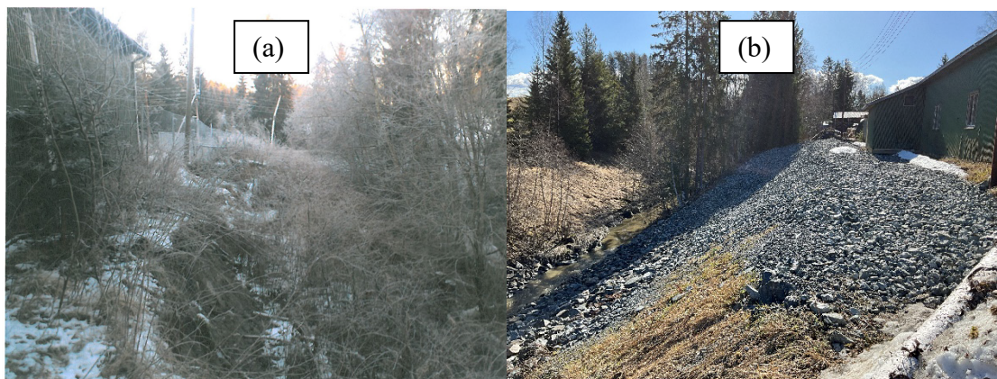
Figur 3-2. a) 04.12.2012: utglidning sett fra øst - mot vaskehall og Egnerveien (ref. /15/), b) 16.04.2024 Steinplastring og fylling sett fra vest – mot vaskehallen.
