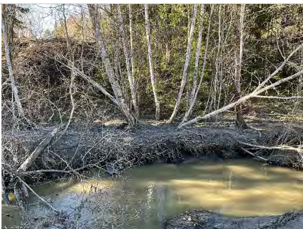
Bilde 18. mot vest, litt erosjon i bratt bekkekant. Veltede trær
