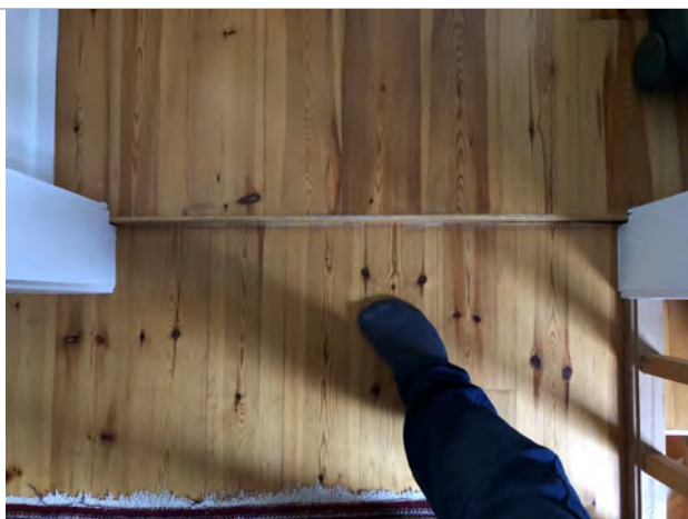
Bilde 14: Sprekk i gulvet mellom opprinnelig hus og tilbygg, i overetasje. 2018.
