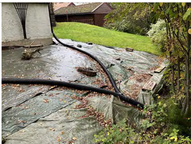
Bilde 5. Plenen nordvest for Skibakkveien 12 har vært tildekket av plast siden 2018. Takvann ledes ned til skråningsbunn i rør.
