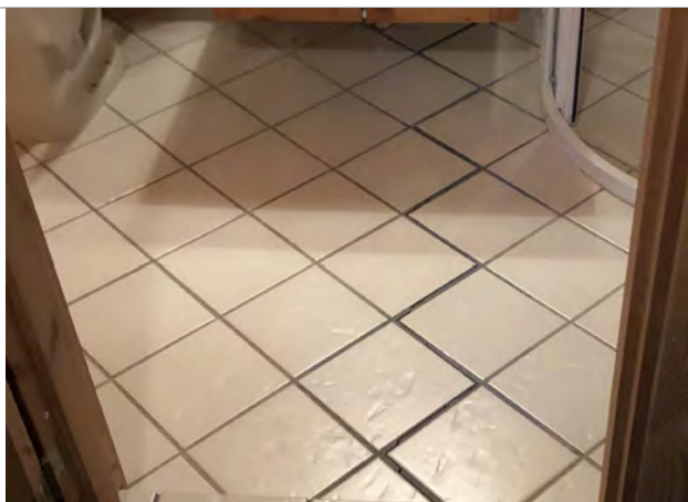
Bilde 10: sprekk mellom flis i badet i underetasje. 2018.
