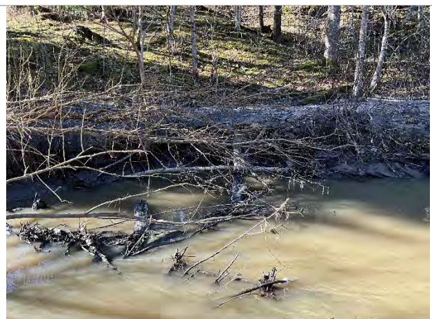
Bilde 19. Oppstrøms (nord) for veikulverten. Litt erosjon (flomslette).
