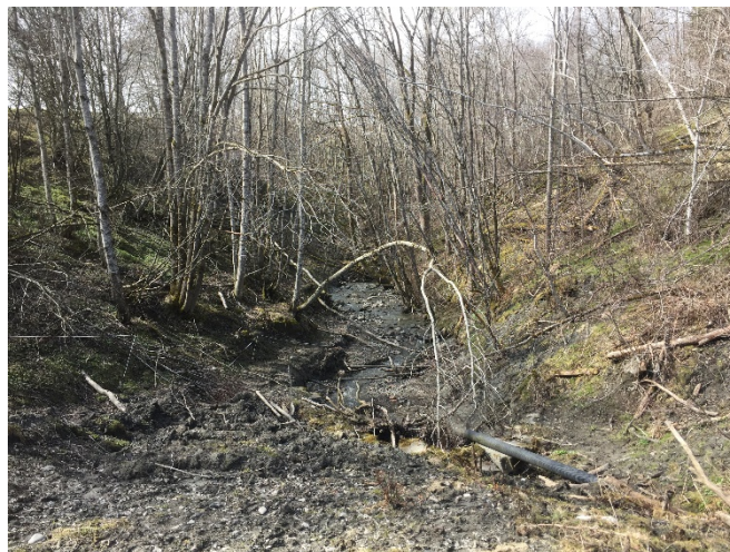
Figur 7: Korsgatabekken går i en lengre kulvert mellom P730-P870. Erosjonssikringen vil gradvis gå over i eksisterende terreng høyde ved kulvertens innløp og utløp.
