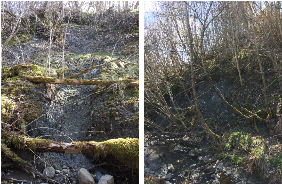
Figur 9: Erosjon og utglidninger i Korsgatabekken.
