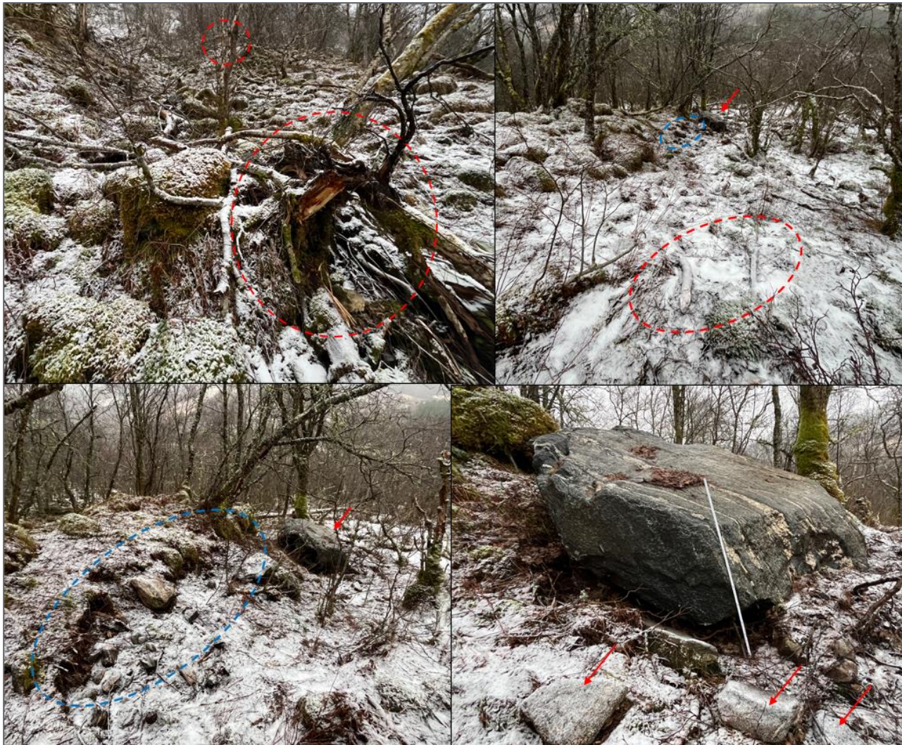
Figur 15 Spor etter antatt fersk steinsprangaktivitet ved infopunkt 8, med synlig skredskadet skog og synlige spor i vegetasjonen etter steinspranget. Rød stiplet sirkel viser skredskadet skog, blå stiplet sirkel viser spor i vegetasjonen og rød pil viser steinsprangblokker. Målestokken på bildet er 1 m, og er brukt som skala.
