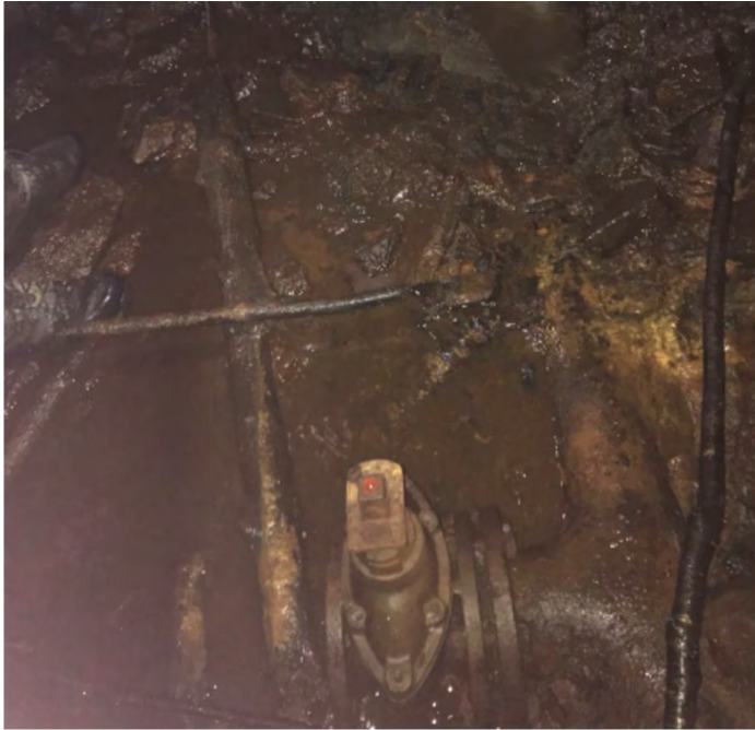
Figur 15: Ventilen i tapperøret er i dårlig forfatning og bør skiftes ut. Ifølge Råde Graveservice AS ble tapperør og ventil i tunnel benyttet til å tappe ned magasinet da dammen ble rehabilitert i 2013/2014. Det er usikkert om ventilen er trykksatt i dag.
