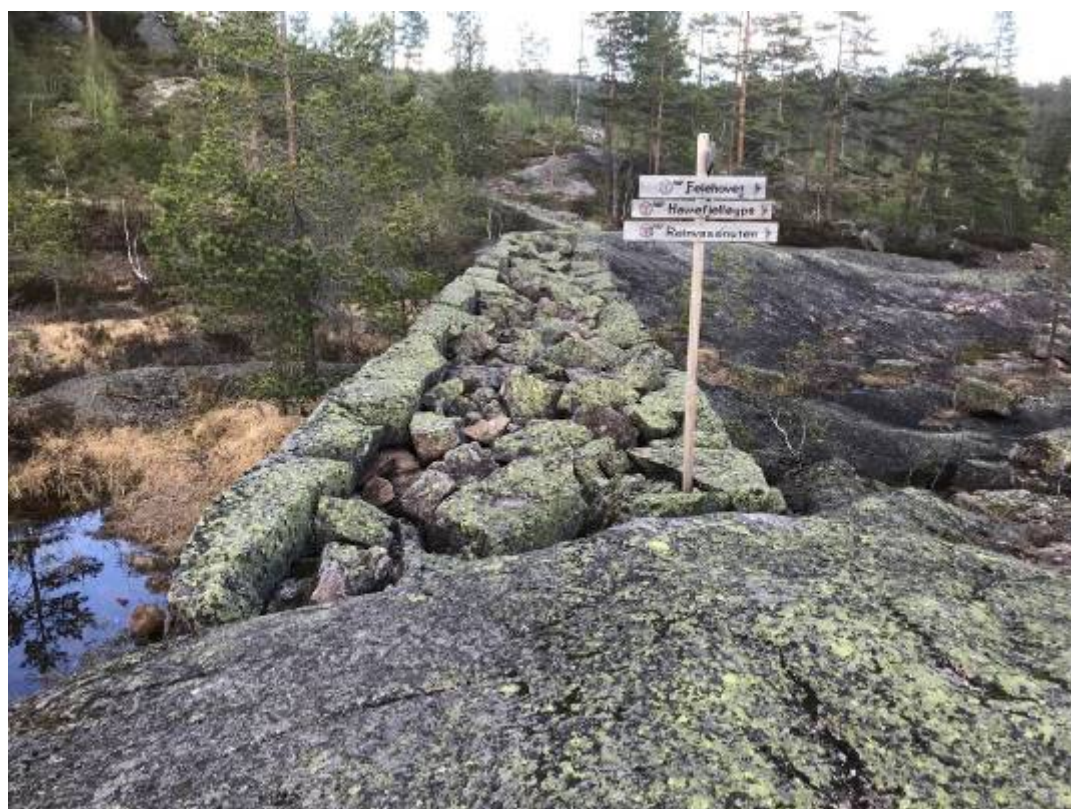
Bilde 32: Bjønntjønn dam sett mot øst. Dammen må tettes/restaureres. Foto: Rolf Amundsen
