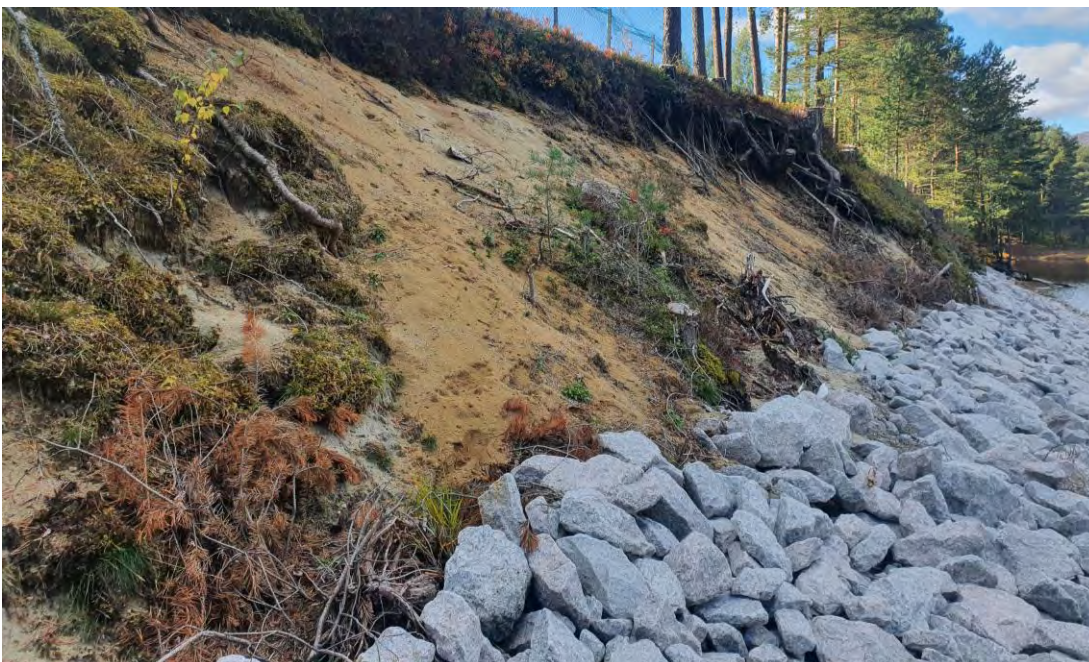
Bilde 3 Skråning mellom erosjonssikring og fotballbane. Noe vegetasjon etablerer seg i den bratte skråninga, men det tar lang tid.
