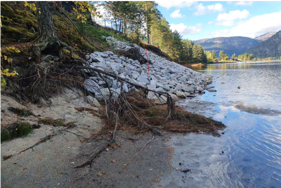
Bilde 1 Eksisterende erosjonssikring ved fotballbanen på Rysstad. Treet nærmest erosjonssikringa er delvis undergravd av bølgeerosjon og er forutsatt fjernet.
